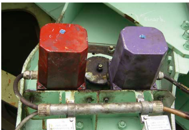
Vorher: Über Zahnradantrieb angetriebene mechanische Spindelendschalter für das Überwachen und Schalten von Endpositionen.
