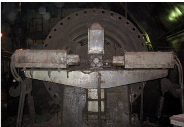
Vorher: Alte Skip-Car-Steuerung mit zwei mechanischen Getriebe-Nockenschaltwerken.
