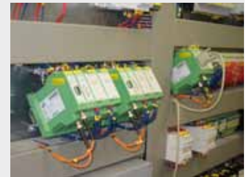
Elektronische Funktionsmodule installiert im Schaltschrank Elektronic funktion modules installed in switchboard
